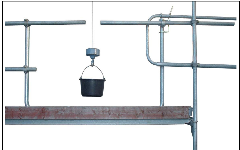
Fig. 6 Sicherung der Be- und Entladestelle
